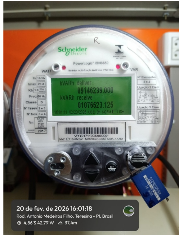
Meter 4 (UTE COMVAP - Check)
