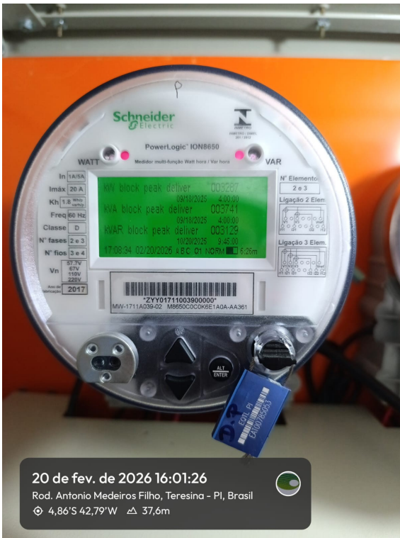
Meter 3 (UTE COMVAP - Main)
